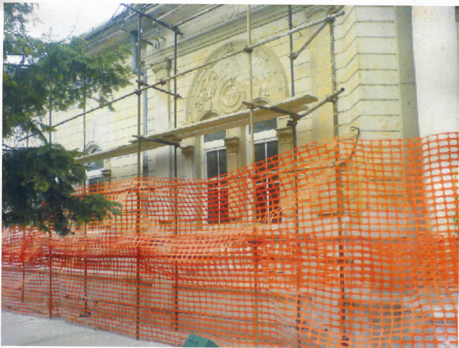
РЕКОНСТРУКЦИЈА ЈЕДНЕ ОД НАЈЛЕПШИХ ЗГРАДА У НАШОЈ ОПШТИНИ, А ТО ЈЕ ЗГРАДА М.З. ГОСПОЋИНЦИ
